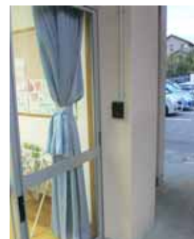
臨時出入口に取り付けたインターホーン
